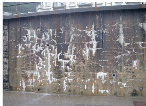
Abb. 2: AAR-Schaden bei einer Stützmauer
