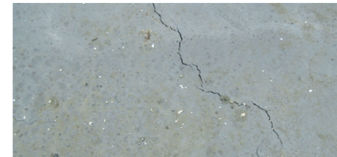
Typische Fröhschwindrisse infolge vorzeitiger Austrocknung einer Betondecke.
